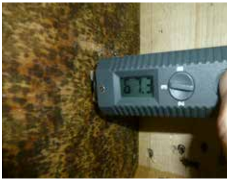
Pilzbelastung durch hohe Baufeuchte wegen Estrich- und Putzeinbau an der Dachunterseite innen.
